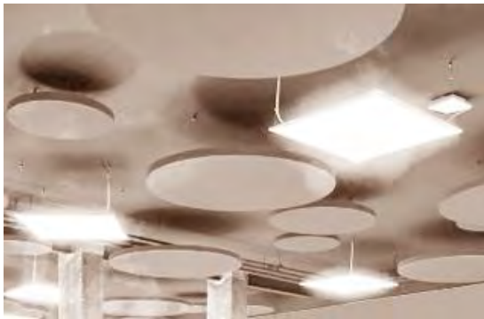
Ejemplo de techo con instalaciones vistas y luminarias y paneles fonoabsorbentes colgados.
